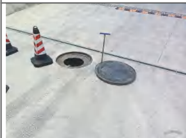
地下水监测井
