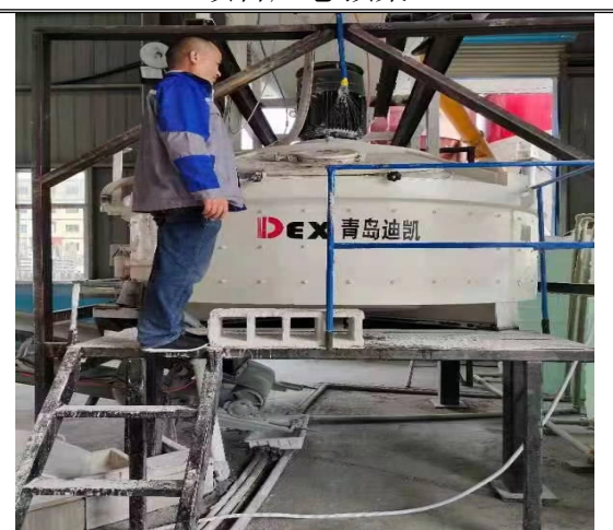
喷雾降尘设施
