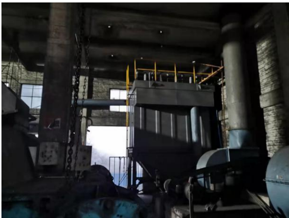
布袋除尘器整体
