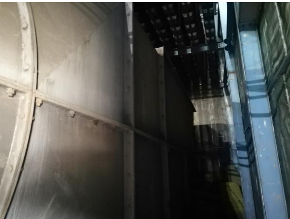
通风机减噪排放口
