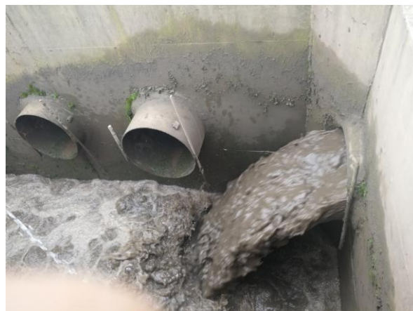
矿井水处理进水口
