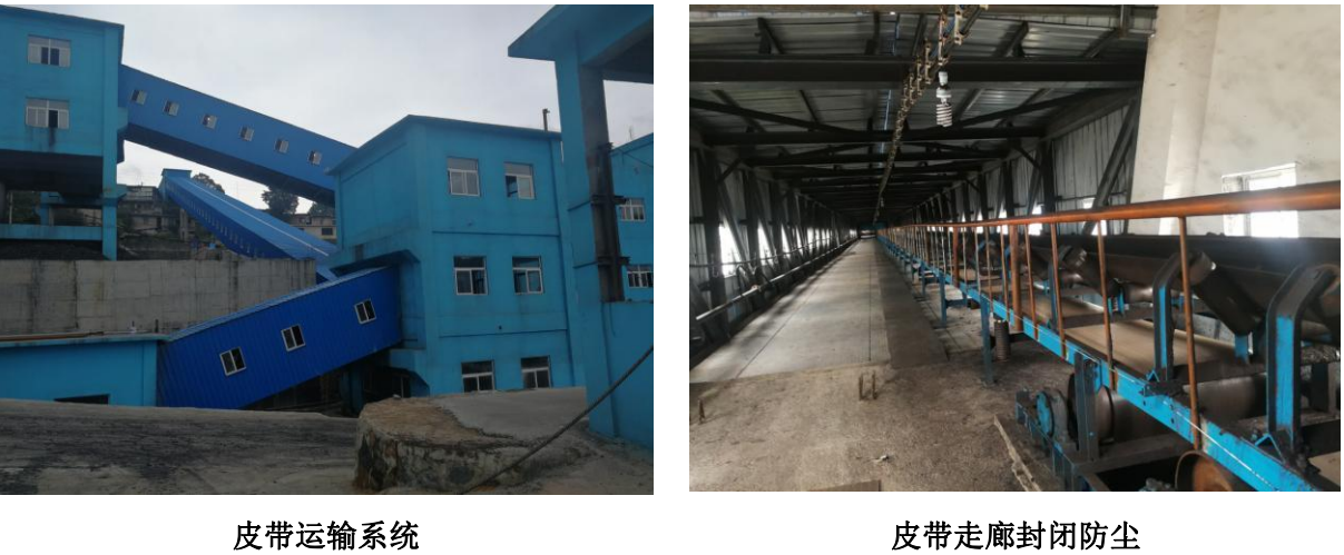
图 8.2-2 老鹰山煤矿储运系统防尘措施照片
