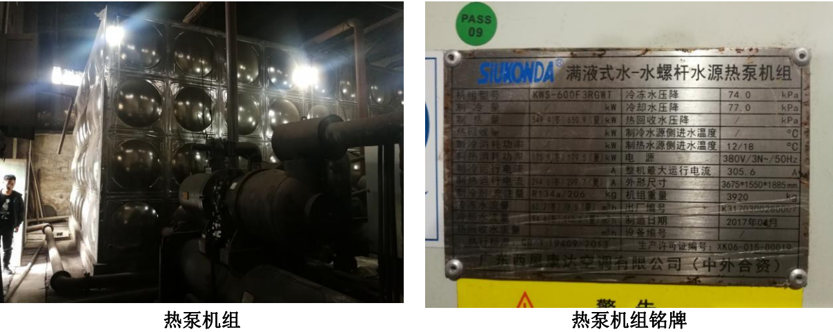
图 8.2-1 老鹰山煤矿热泵机组照片
