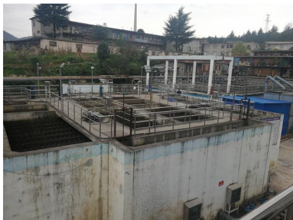
矿井水处理系统
