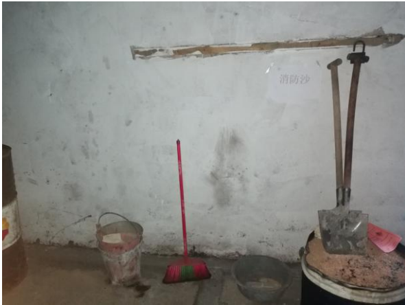
废机油危废间消防设备
