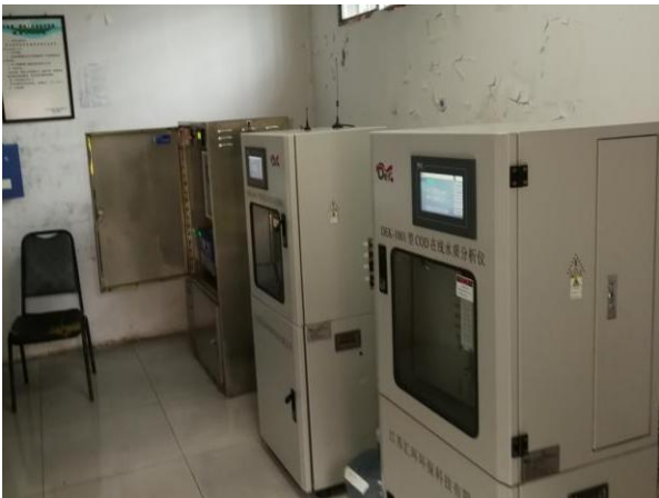
矿井水处理站在线设备
