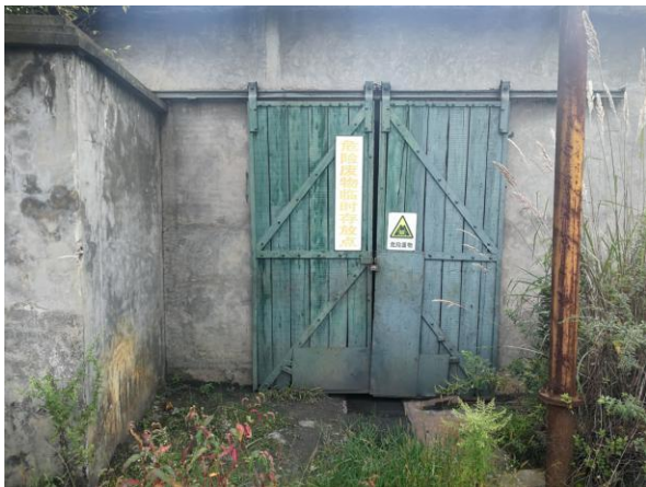
废旧电池危废间
