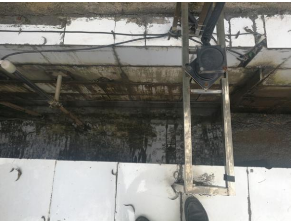
矿井水处理站排放口
