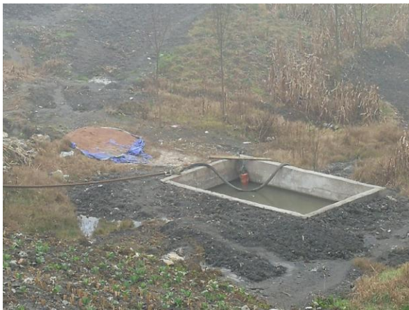
坝下淋溶水收集回送
