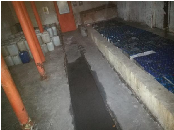
废旧电池危废间内部
