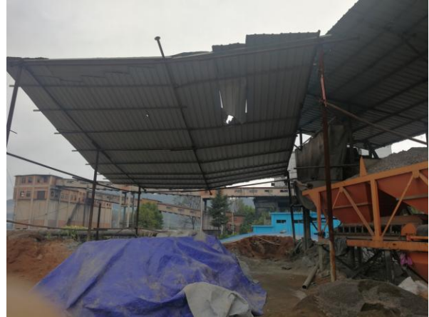
建筑材料及设备遮挡
