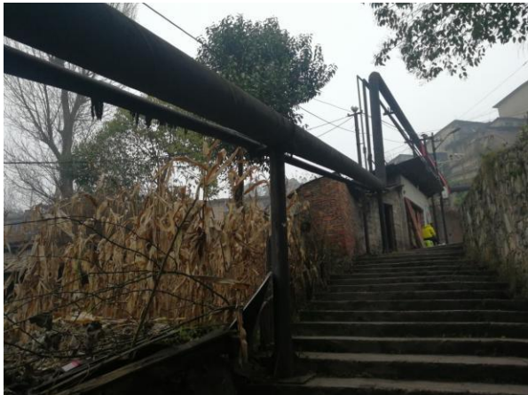
瓦斯抽放管道
