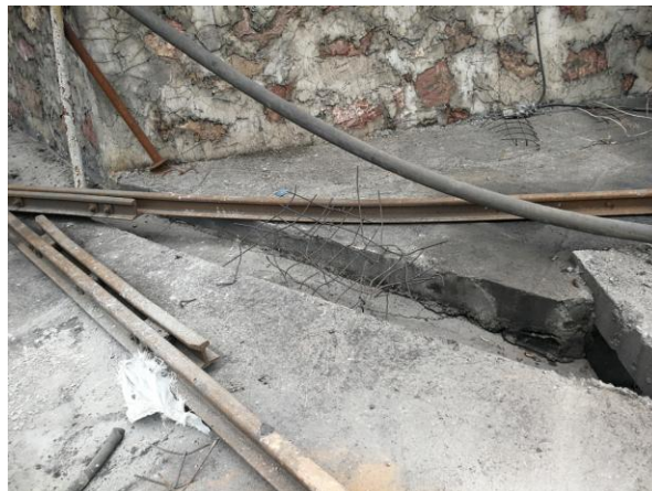
工业场地污水沟
