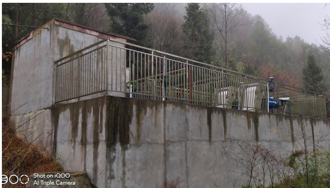
塘坊提升泵站
