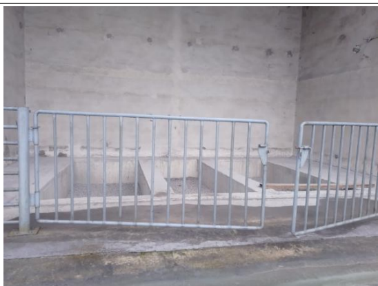
磷炉变事故油池
