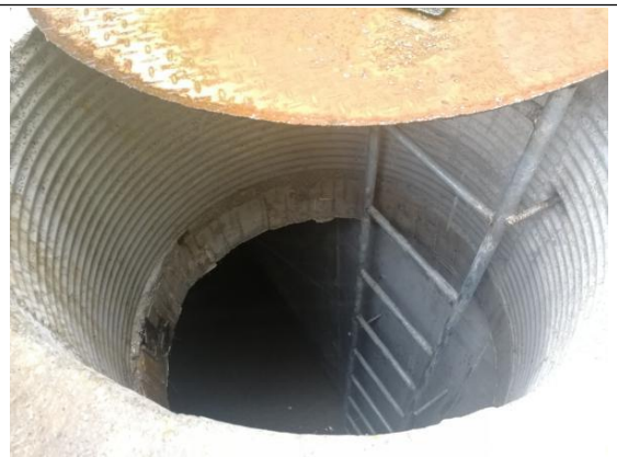
降压站事故油池
