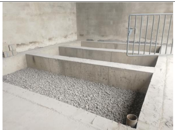
磷炉变事故油池
