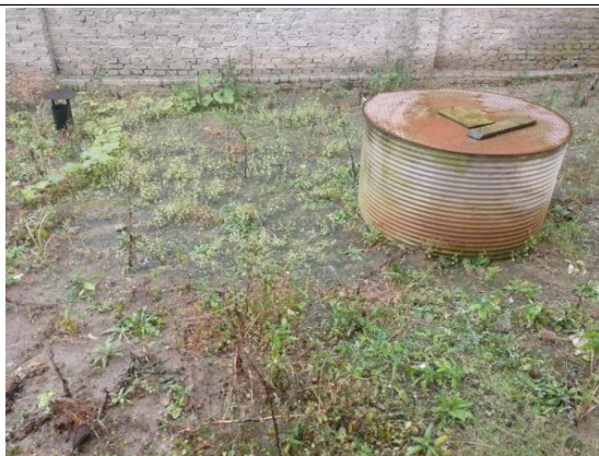
降压站事故油池
