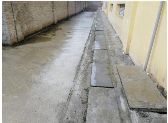
降压站站内排水沟
