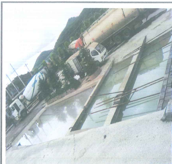
雨水等收集的沉淀池
